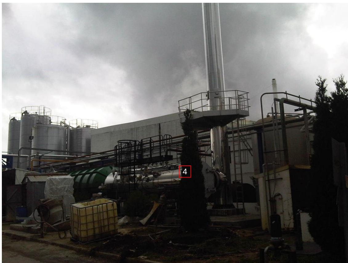
Figura 16 – Central de Oxidação Térmica
